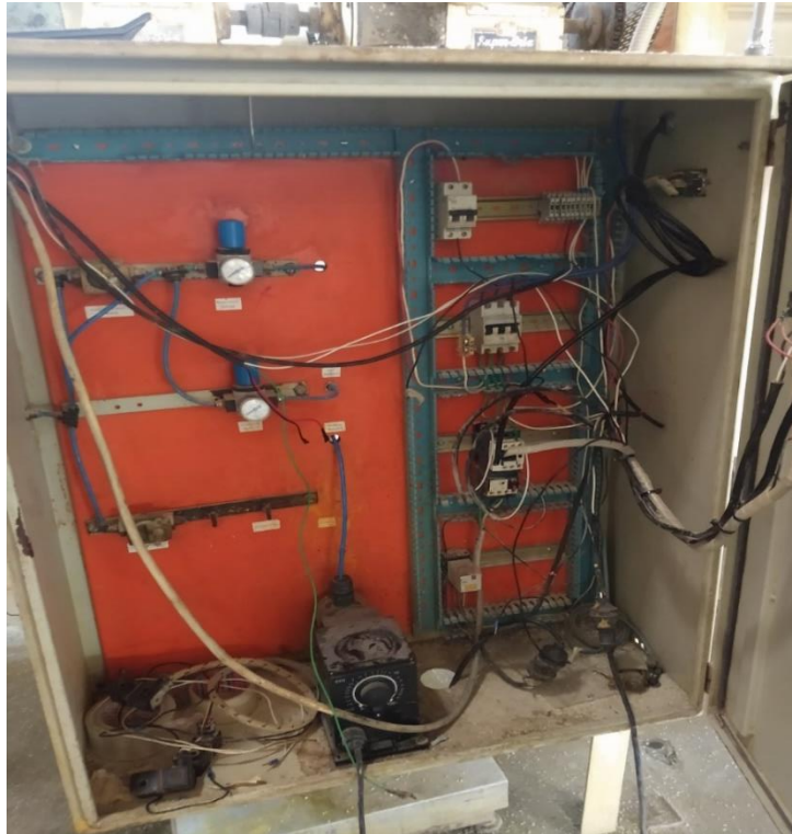
Figura 18. Tablero eléctrico con partes faltantes. Fuente: los autores
