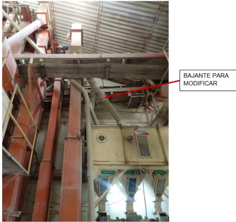
Figura 31. Bajante para cambiar. Fuente: los autores.
