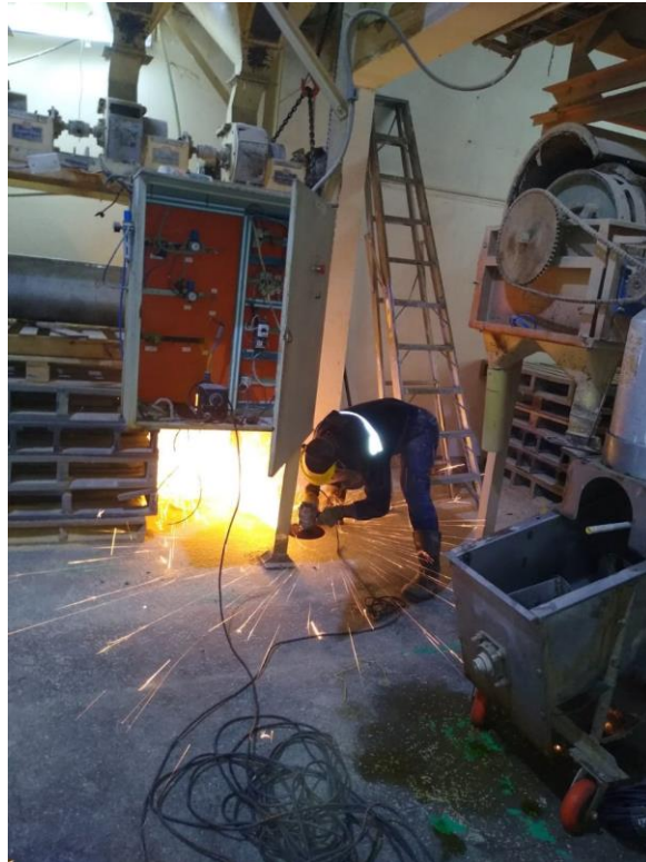
Figura 30. Modificaciones estructurales en la tolva de remanencia. Fuente: los autores
