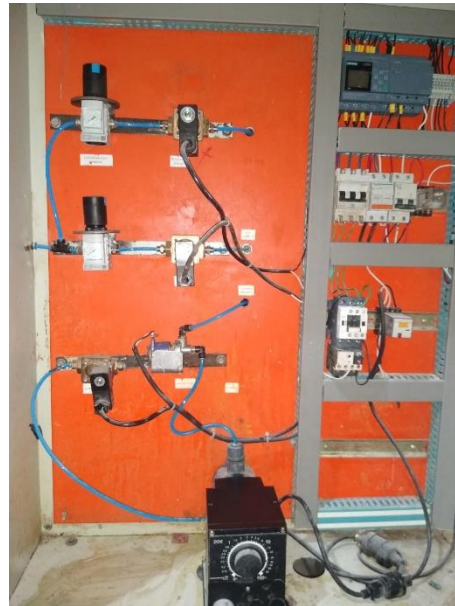
Figura 47. Tablero eléctrico de mando automatizado. Fuente: los autores
