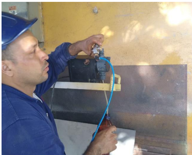
Figura 37. Pruebas de caudal bomba. Fuente: los autores
